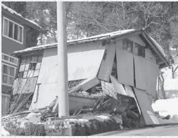
斜めに倒れそうな倉庫
