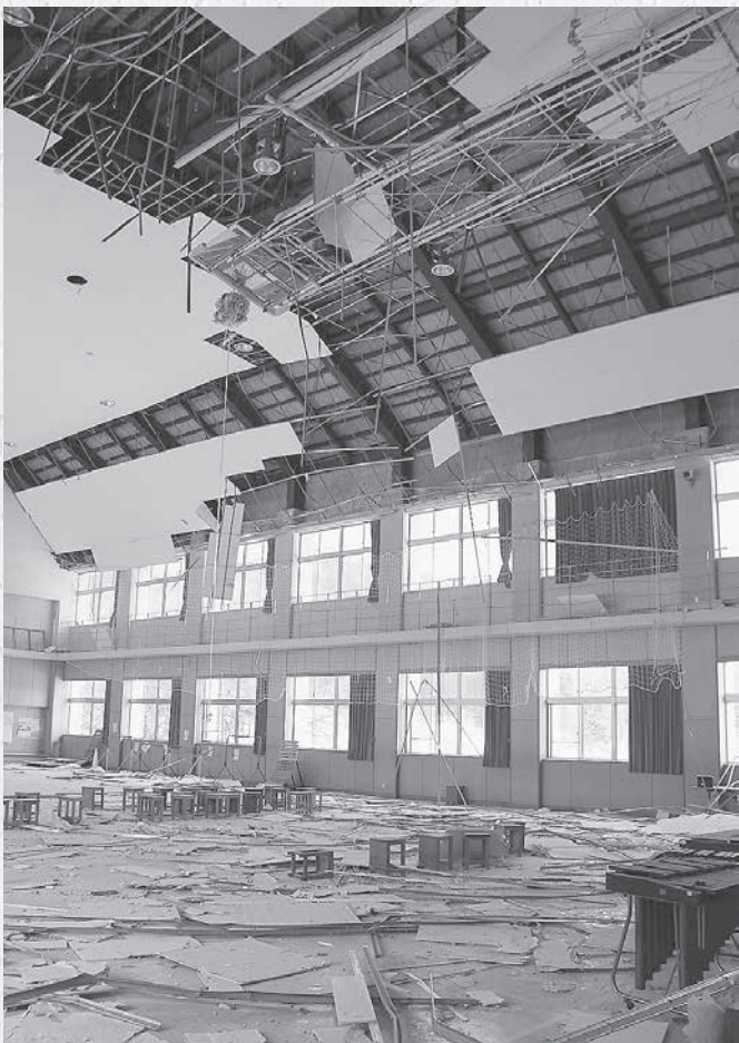
体育館の天井が崩れ落ちた上郷小学校
