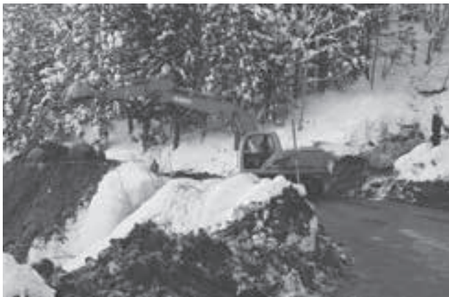
↑重機により道路の土砂は排除され21時間ぶりに開通した
