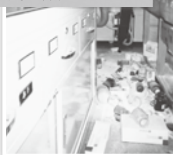
被害を受けました
