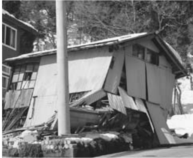
↑地震で崩れた倉庫(小島集落)。3月14日現在の情報収集で、住宅1、作業所等5が、この地震で全壊しました。特に被害が多かったのが、上郷と外丸地区でした。
