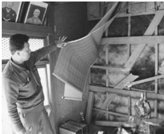
↑筋交いが折れた住宅(寺石)。震源だった長野県境に近い上郷地区は、特に被害がひどかったようですが、町内全域で、壁はがれ、ヒビなどの被害が報告されています。
