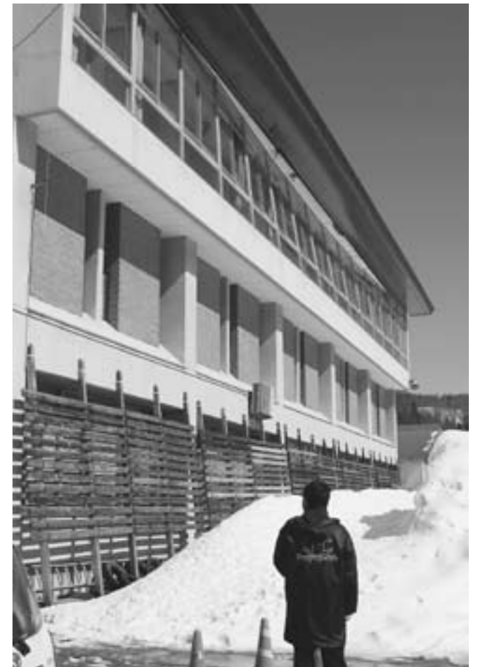
↑地震で体育館の窓枠がはずれた上郷中学校。被害がひどく、立ち入り禁止措置となりました。生徒は16日から津南中学校の校舎で、授業を再開することになりました。こちらも未明の地震で、校内に生徒がいなかったため、人的被害はありませんでした。
