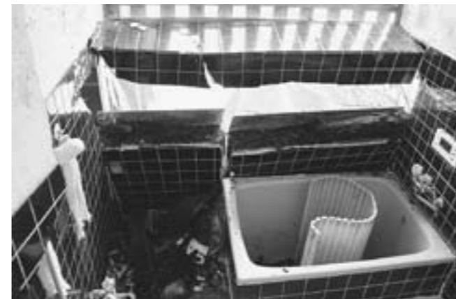
↑お風呂の壁がぐずれ落ち、外が見える状態になってしまった住宅(寺石集落)。断水地区以外にも、お風呂が壊れたことで、入浴できない家が多かったです。そこで、ニュー・グリーンピア津南、綿屋旅館、竜神の館、十日町市の温泉施設の皆さんのご厚意により、お風呂の無料開放が行われました。この無料開放は、町内だけでなく、十日町市、栄村の被災者からもたいへん喜ばれました。
