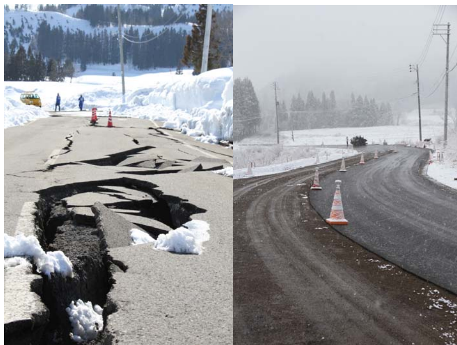
（写真左：震災直後 写真右：修復後）
