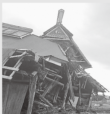
崩壊する源内山の空き家
