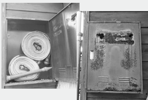
集落内消火栓ホース・格納庫
