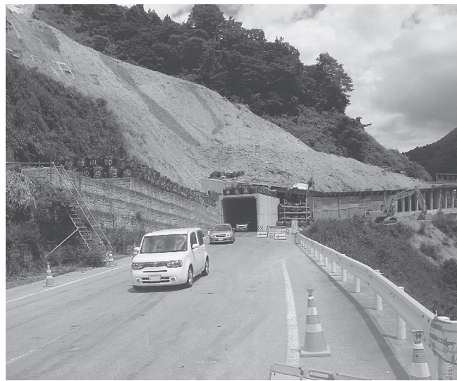
早期復旧を(国道353号崩落現場)
