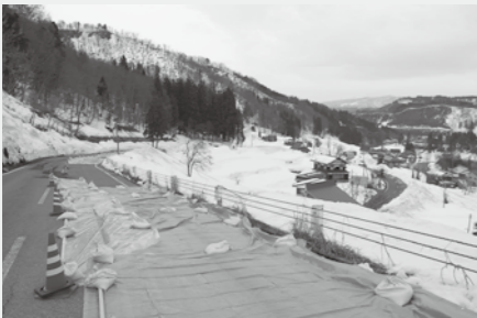
路肩が崩壊した田中地内
